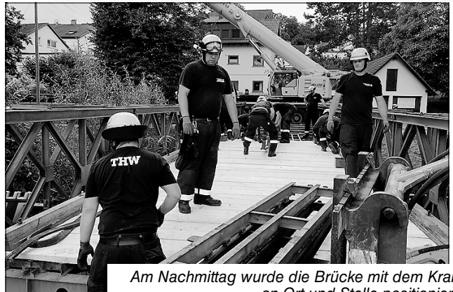
Helfer des THW haben die Strahlkonstruktion für die Behelfsbrücke auf der Lindenstraße zusammengeschrubt.
